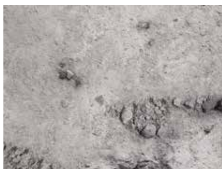
Odstraniti je treba vse elemente, ki niso trdno vezani na podlago.
