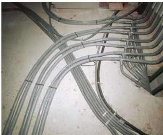
Slika 9: Podlaga s cevovodno napeljavo
