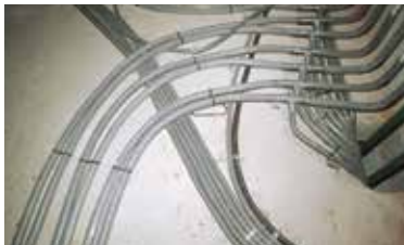
Slika 7: Podlaga s cevovodno napeljavo
